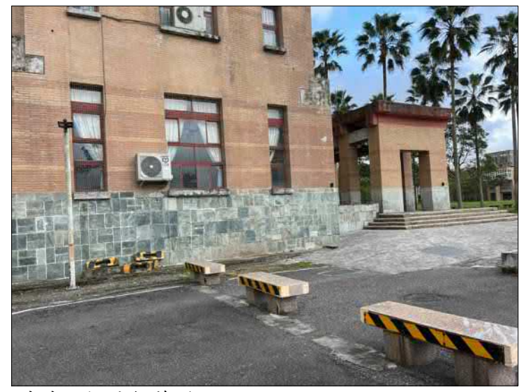
外牆石板片剝落-1
