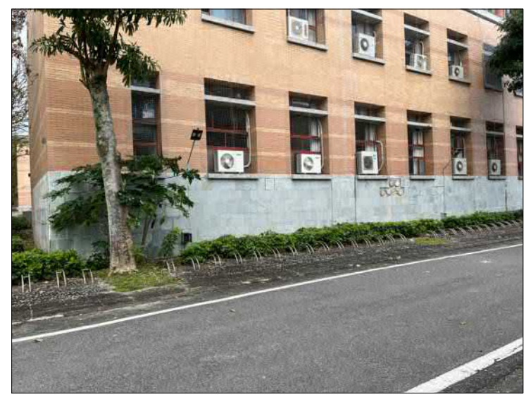
外牆石板片剝落-2
