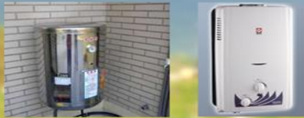
熱水器符合要求 Water Heater to meet the requirements 瓦斯型：裝置於室外 電力型：防漏電裝置
