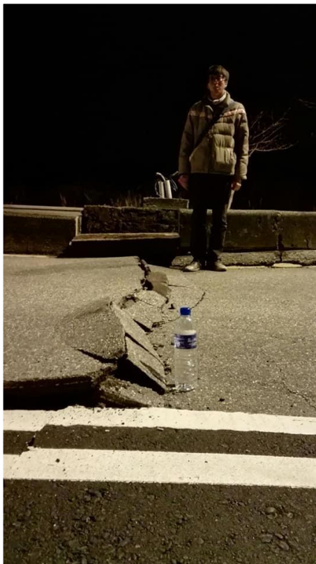
圖7. 花蓮大橋橋面破壞拍攝
